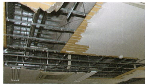
漏水被害により崩落した天井
