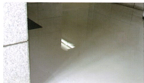
廊下に溜まった漏水
